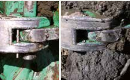
ピンの切断により拡大掘削を確認
